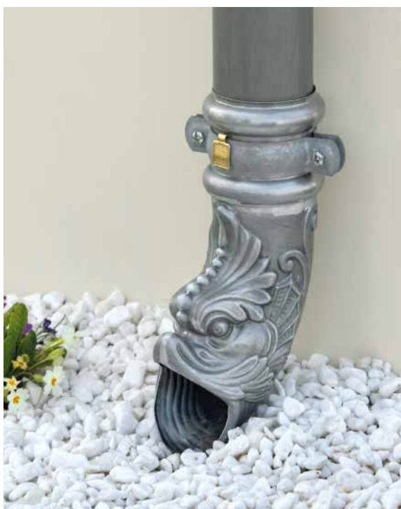
Evacuation des eaux pluviales - Coude dauphin
